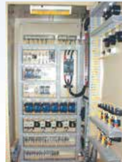
廃水処理制御盤
